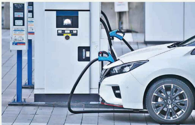
電気自動車のバッテリーに電気を充電しているところ。充電のしくみとしては、スマートフォンと同じです。
